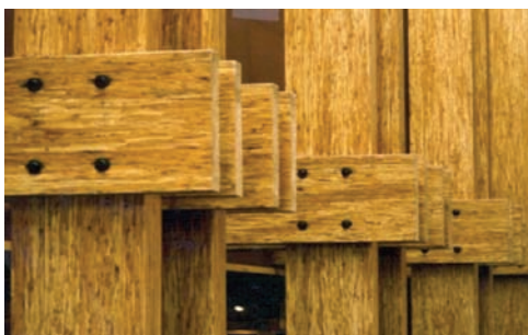
Figure 2. Les assemblages boulonnés utilisés dans la construction en bois de fortes dimensions
